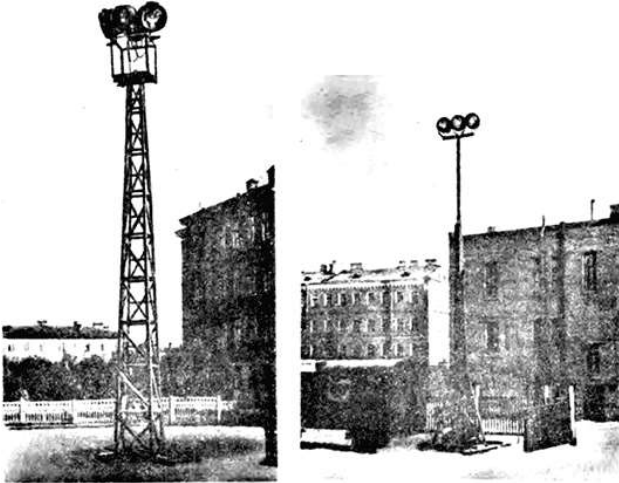
Рис. 10. Инвентарная бесфундаментная прожекторная мачта высотой 10 м на строительстве котельной
