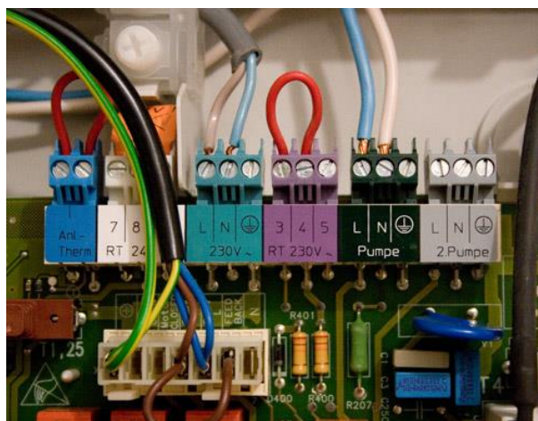
Рис. 54 Комутация проводов пульты управления
